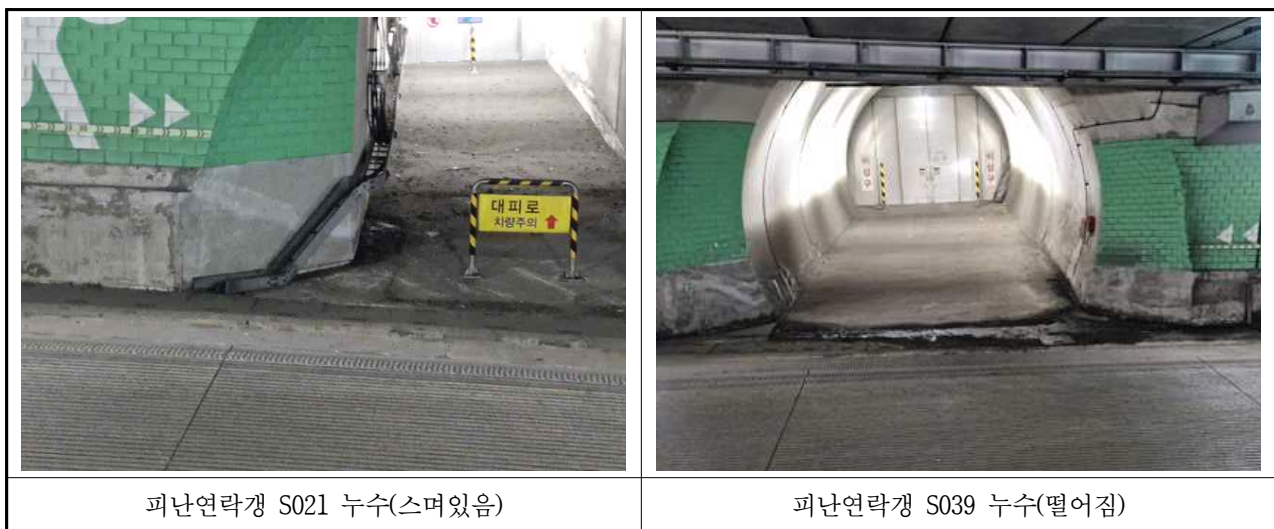
【사진 3.3.38】 피난연락갱 손상현황
