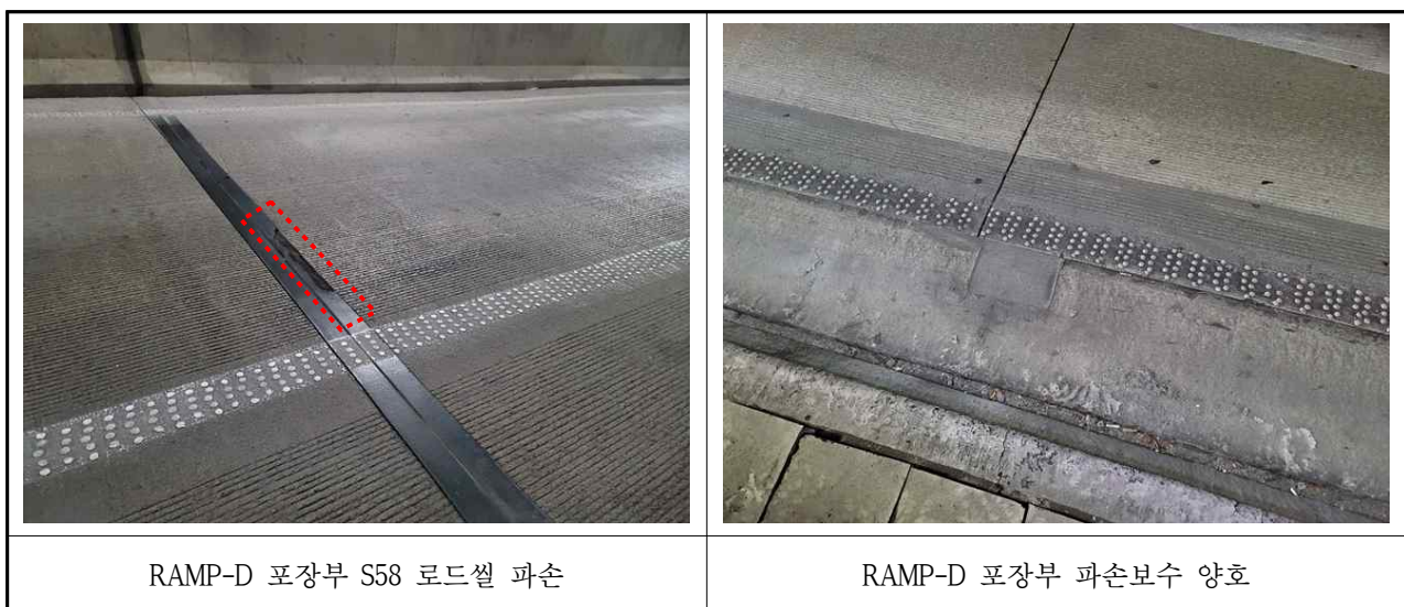
【사진 3.3.30】 포장부 손상현황
