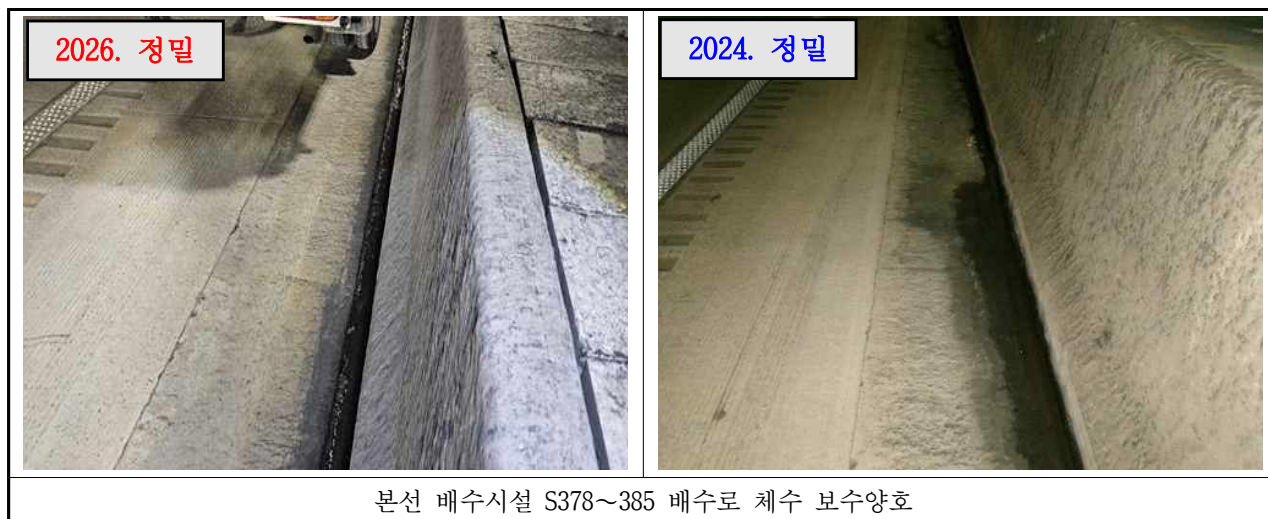
【사진 3.3.16】 배수시설 손상현황
